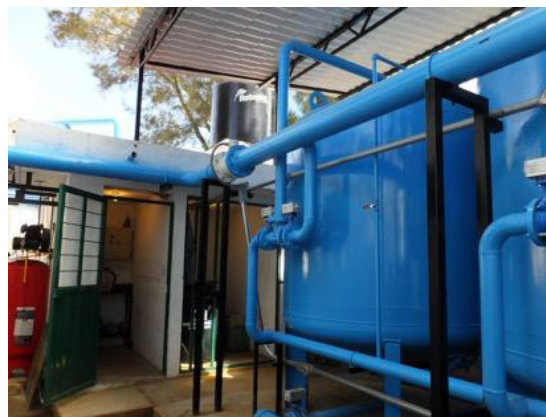
Imagen 5.6. Planta para la remoción de arsénico ubicada a un lado del tanque principal en la cabecera municipal
