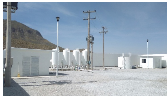
Imagen 5.2-D. Planta potabilizadora de filtración directa a presión del pozo 15 Pueblo Nuevo, Gómez Palacio, Durango.
