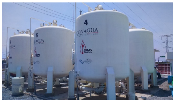
Imagen 5.2-B. Planta potabilizadora de filtración directa a presión del pozo 7 en Matamoros, Coahuila.
