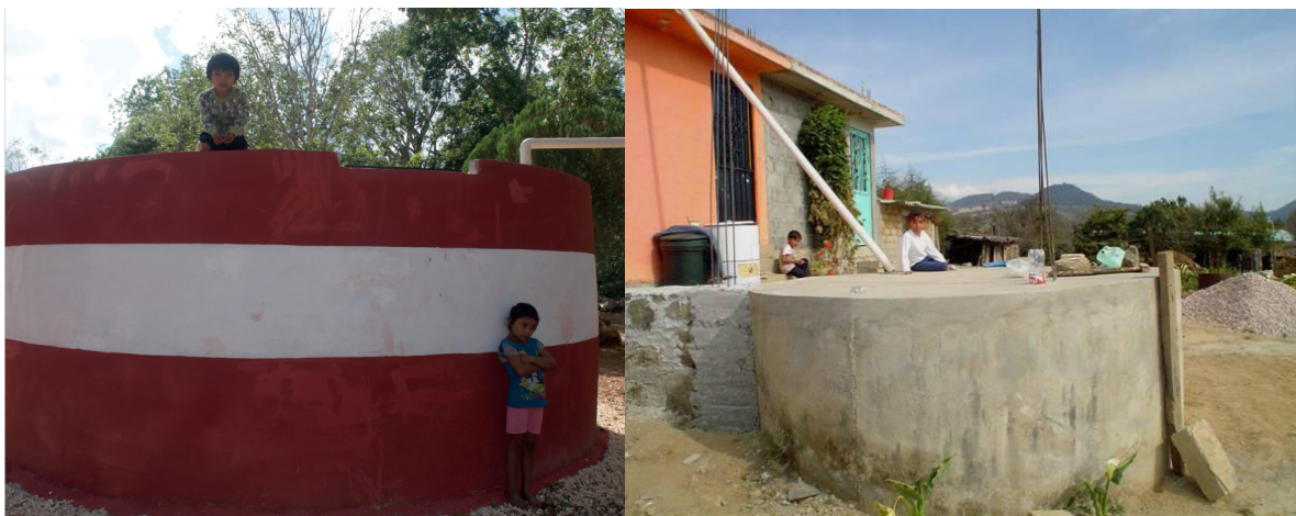
Imagen 7.1. Captación pluvial y cisternas escala doméstica en Morelos
