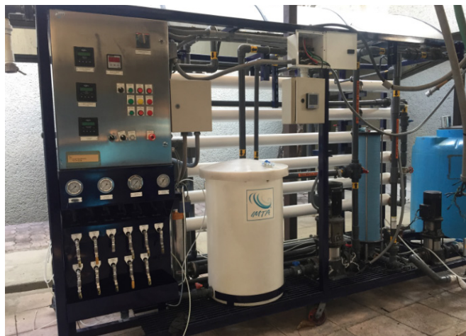
Imagen 4.3. Planta piloto de filtración por membranas
